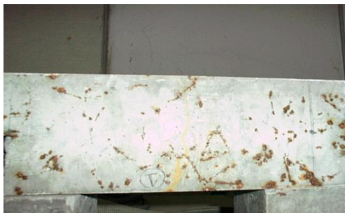
Figura 6. Corrosão superficial em BRFA [14]
